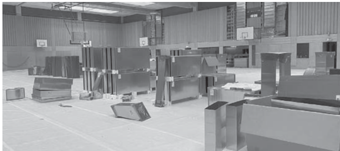
Auch die Albert-Einstein-Schule in Schwalbach erhält eine Lüftungsanlage wie diese an der Heinrich-Böll-Schule Hattersheim. Sie soll im kommenden Jahr fertiggestellt werden. Foto: MTK
