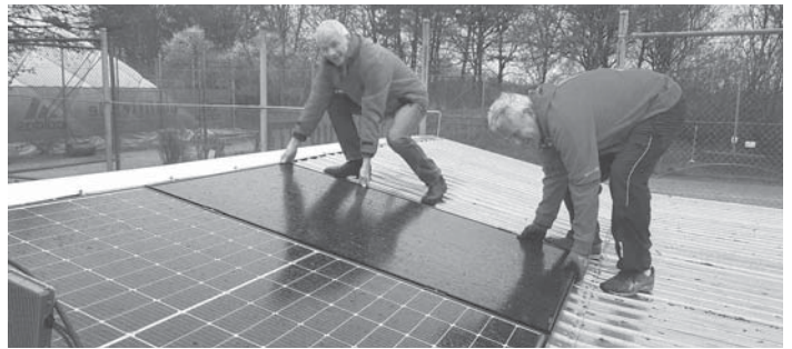
Initiator Klaus Wenzel (links) und Anlagenwart Eckhard Finke kontrollieren die Solarmodule. Foto: gsg
