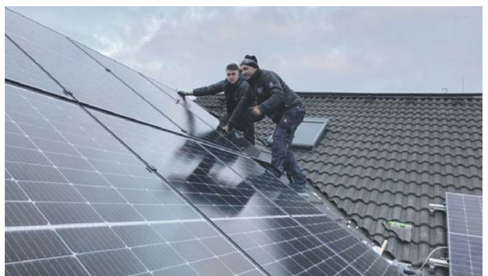
Das Team von Elektro Kollmann hat schon zahlreiche Häuser in Schwalbach und Umgebung mit Photovoltaik- und Solarthermie-Anlagen ausgestattet. Foto: privat
