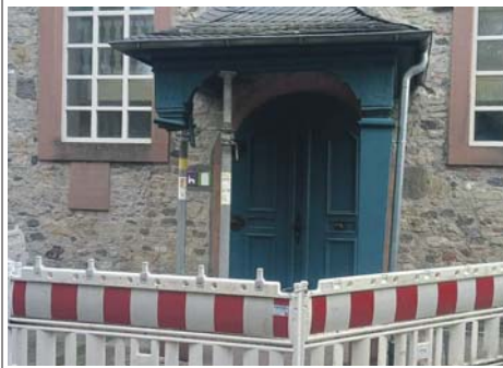
Offenbar umgefahren wurde einer der Holzpfosten, die das Vordach über dem Eingang zur evangelischen Kirche halten. Foto: Mirwald
